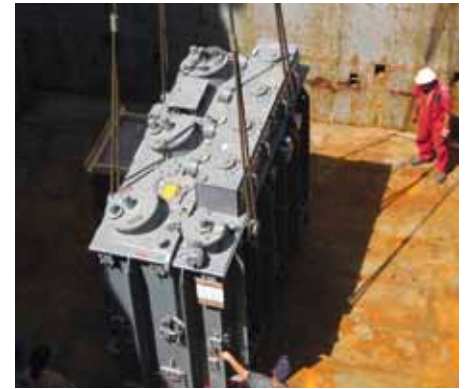
Stauung eines Transformators unter Deck
